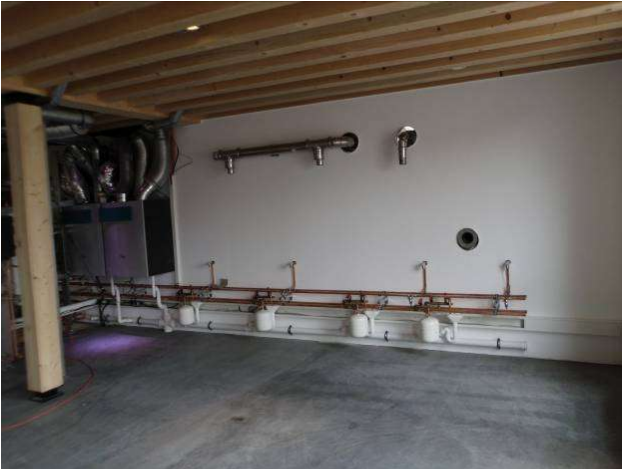
Anschlussplätze für Ausstellungsheizungen
