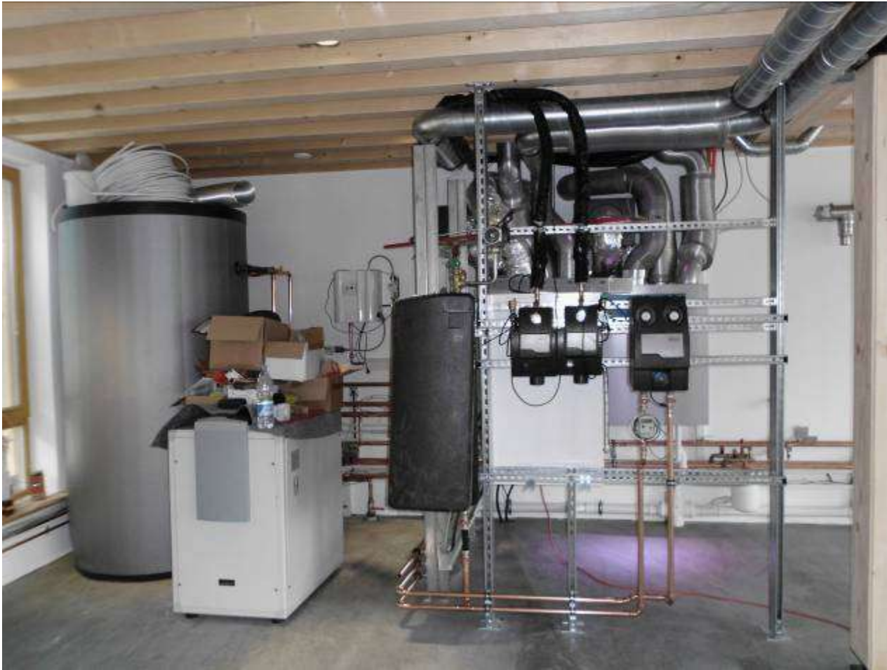
Wärmepumpe, Pufferspeicher, Pumpengruppe
